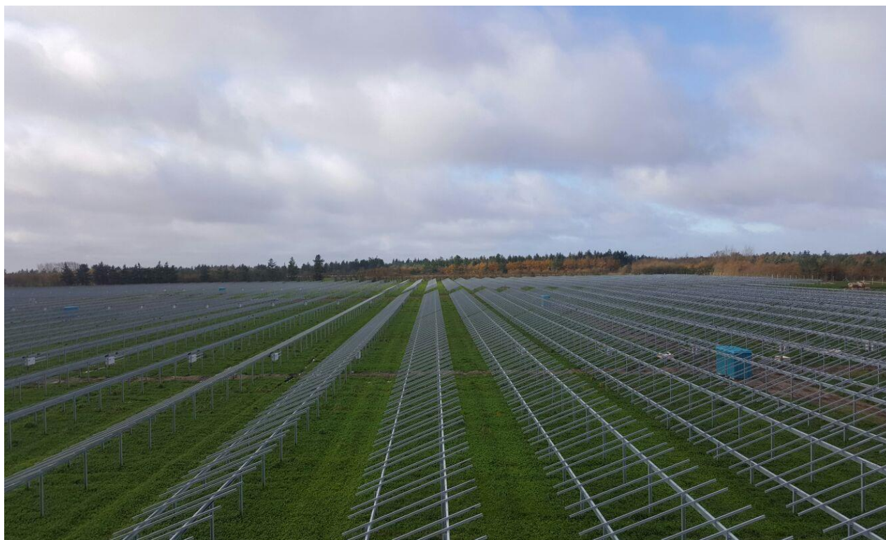
Rysunek 15 Konstrukcja wsporcza oparta na dwóch rzędach profili wbitych bezpośrednio w grunt
