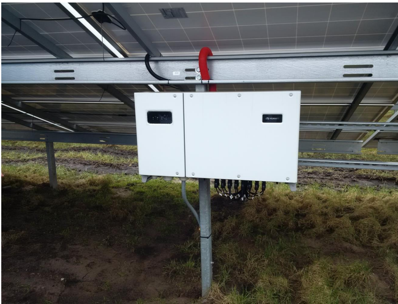
Rysunek 20 Inwerter o mocy 42 kW zamocowany na konstrukcji nośnej paneli fotowoltaicznych
