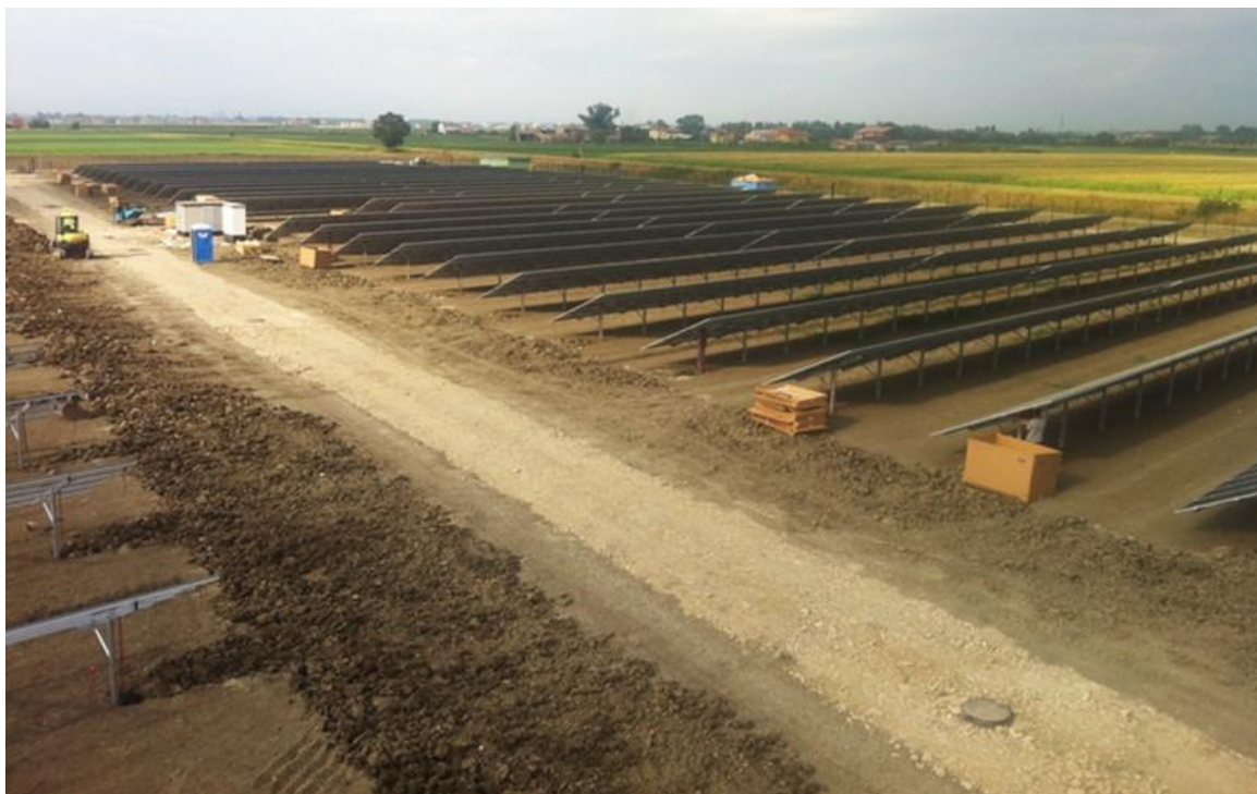
Rysunek 31 Farma na jednym z ostatnich etapów budowy, po montażu modułów i zasypaniu przewodów
