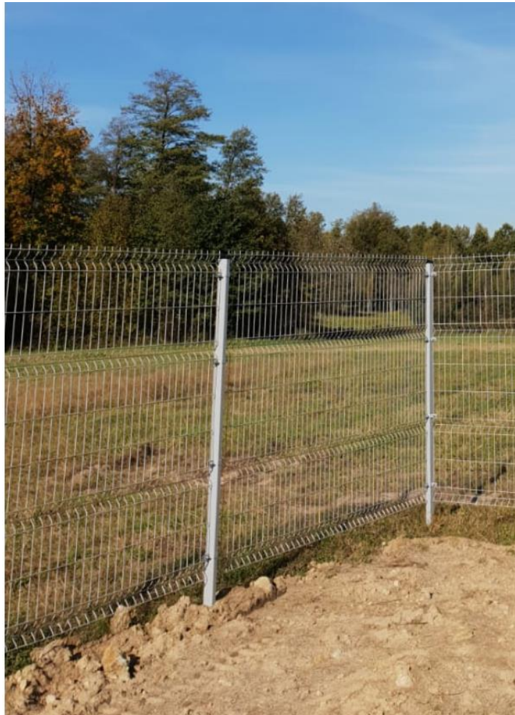
Fot. 3. Ażurowe ogrodzenie farmy fotowoltaicznej z zachowaną przerwą dla migracji małych zwierząt. Źródło: materiały własne firmy ALSEVA INNOWACJE S.A.
