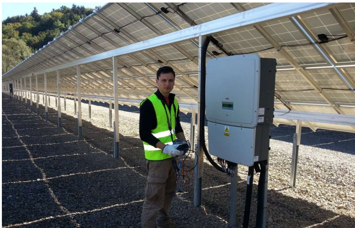
Fot. 3. Instalacja zamontowana pod konstrukcją paneli na jednej z pracujących w Polsce farm fotowoltaicznych w Tymbarku. Zdjęcie www.solgen.pl
