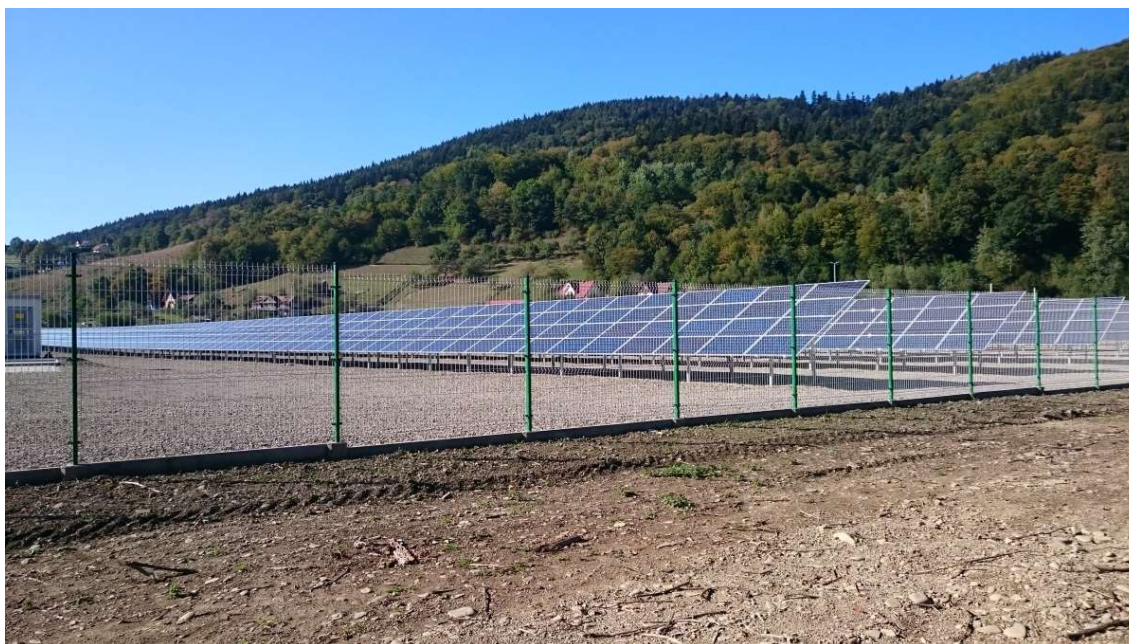
Fot. 5. Farma fotowoltaiczna za ażurowym ogrodzeniem. Z lewej strony widać fragment kontenerowej stacji transformatorowej. Zdjęcie www.solgen.pl .
