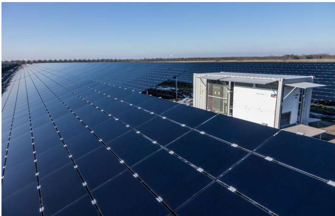
Fot. 4. Kontenerowa stacja rozdzielająca wraz z transformatorem. Zdjęcie www.belectric.com .
